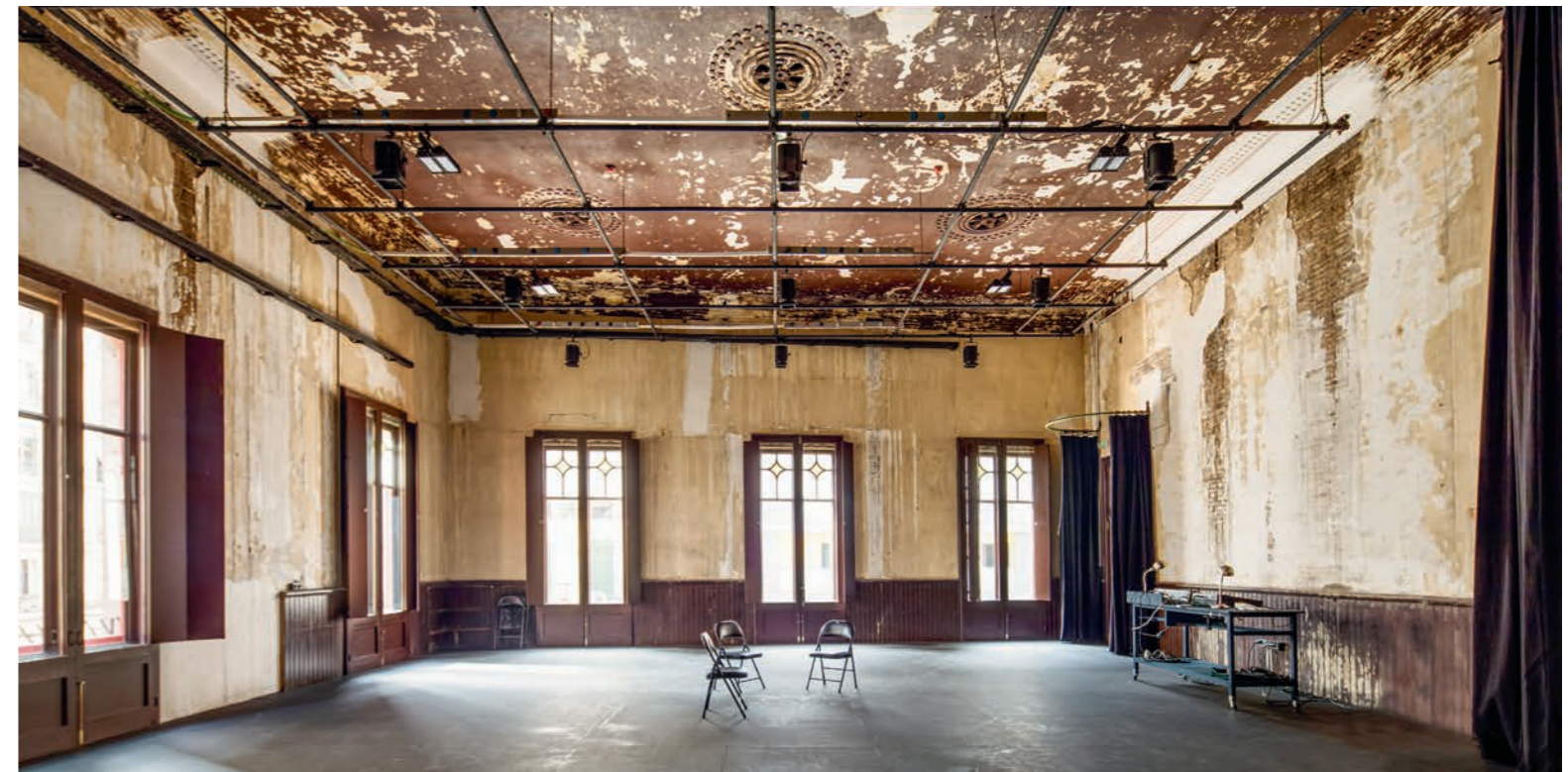
Der Bühnenraum (oben) wurde bereits im Bestandsbau für Vorführungen genutzt. In der heutigen Probebühne (unten) war früher die Bar der Arbeitergenossenschaft, die das Gebäude 1924 errichtete.
