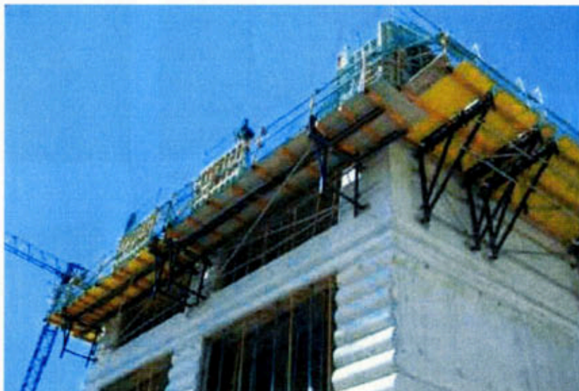
ENVOLUPANT VERTICAL EXTERIOR: FAÇANA PORTANT DE FORMIGÓ VIST IN SITU AMB MOTLLURES
